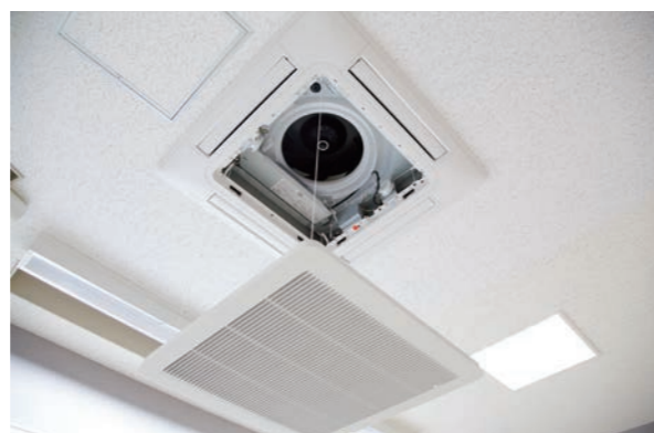
【写真2】電動昇降式の室内パネル
