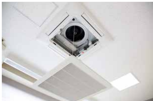
写真2 電動昇降式の室内パネル
