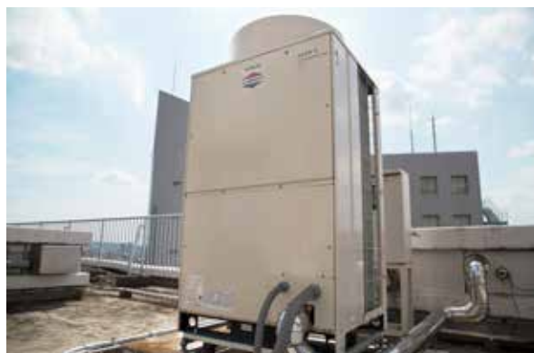
写真1 更新された新しい空調室外機
