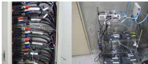
図3 単相3線式の配電系統に取り付けたセンサー設備
