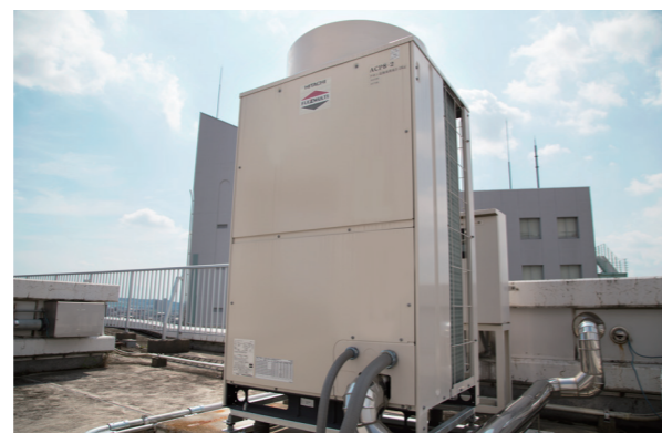
写真1 更新された新しい空調室外機
