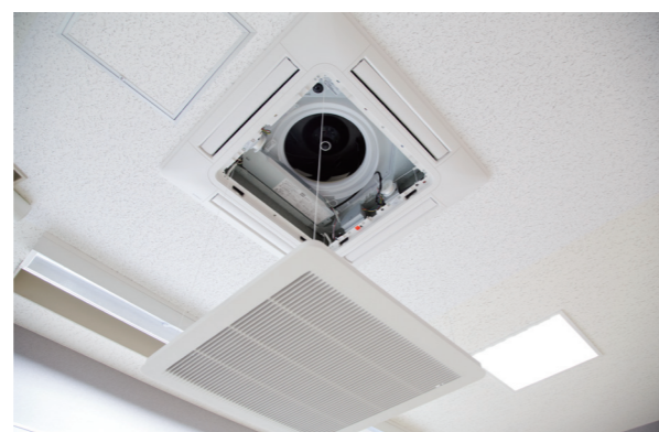
写真2 電動昇降式の室内パネル
