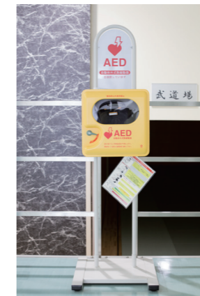
写真 1 体育館内に設置されている AED
