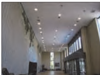
講堂ロビー耐震天井とLED照明
