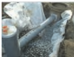
西2号館改修工事での雨水浸透施設 穴の空いた浸透柵や浸透管により地中に雨水を還元します。
