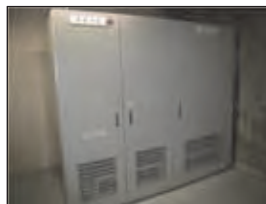
本館蓄電設備
