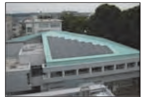
B棟太陽光パネル
