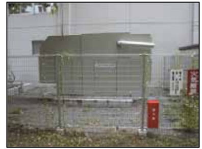
長時間使用可能な非常用発電機
