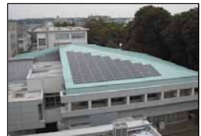
B棟太陽光パネル
