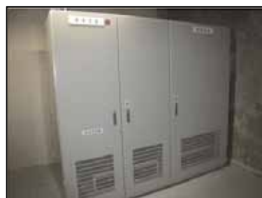
本館蓄電設備
