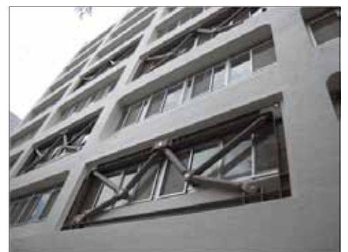
油圧制震ブレース、窓サッシは複層ガラス、網戸付
