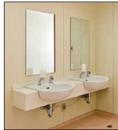
西2号館洗面所 節水効果の高い自動水栓
