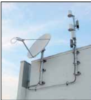
本館屋上の衛星通信システム用 パラボラアンテナと無線LAN アクセスポイント
