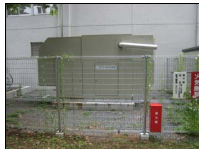
非常用発電設備
