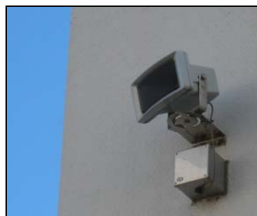
屋外放送設備
